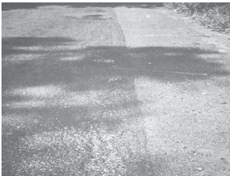
تصویر شماره ۴-۲۳: فرسایش
