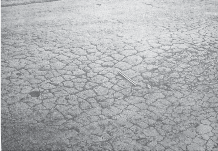
تصویر شماره ۴-۱: ترک پوست سوسماری
