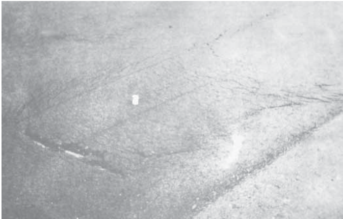
تصویر شماره ۴-۱۵: ترک لغزشی
