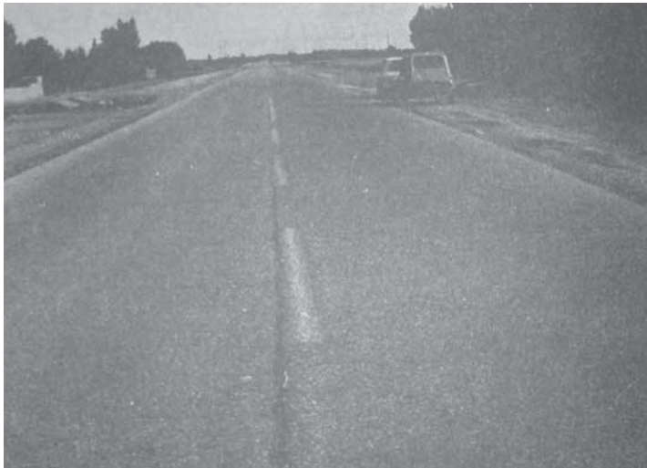
تصویر شماره ۴-۱۰: ترک دوبندی
