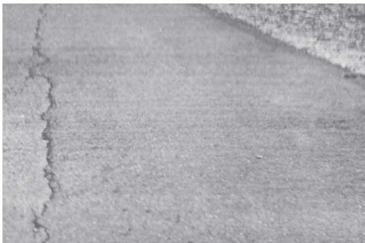
تصویر شماره ۴-۱۶: ترک تعریضی
